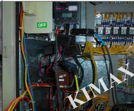
冷卻水塔風扇耗電量測
